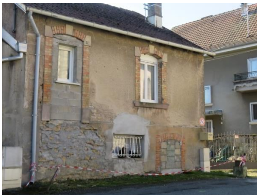
Contre-exemple local de baies transformées, sans cohérence en façade et sans équilibre entre elles.
